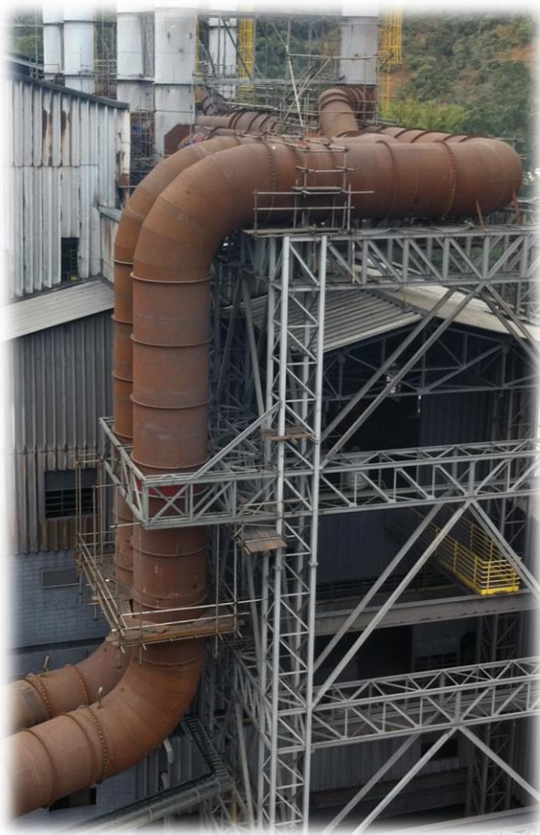
DUTOS DE DESPOEIRAMENTO NOVA ERA SILICON NOVA ERA/MG
